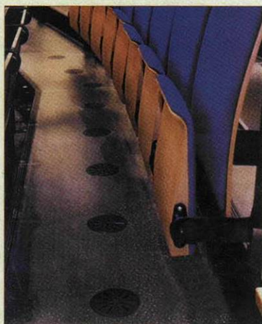
■ Фото А. Подача воздуха через напольные воздухоораспределители с закручиванием струи в аудитории Университета Амстердама
